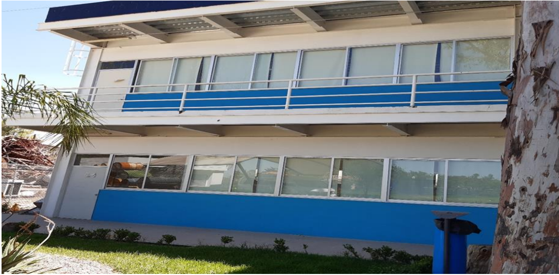
IMAGEN#8 ANTES DE REFORRAR LA SEGURIDAD DE LOS BARANDALES
