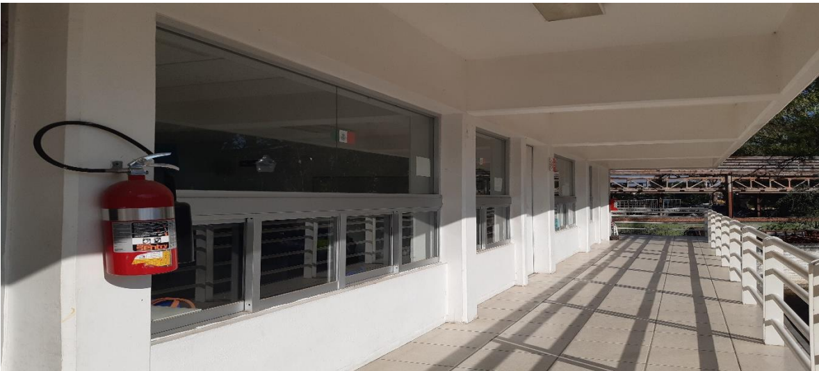
IMAGEN#7 DESPUES DE LA INTALCION DE EXTINGUIDORES
